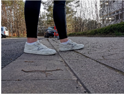
Nullabsenkung (Bordstein auf Höhe der Fahrbahn) ohne taktil erstastbaren Bodenindikatoren
