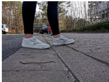
Nullabsenkung (Bordstein auf Höhe der Fahrbahn) ohne visuell kontrastreichen Bodenindikatoren
