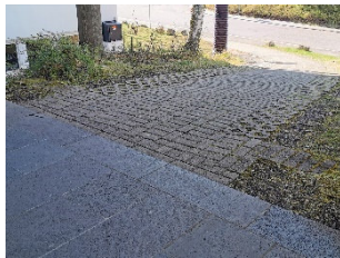
Rampe 17% Steigung ohne taktile Absicherung
