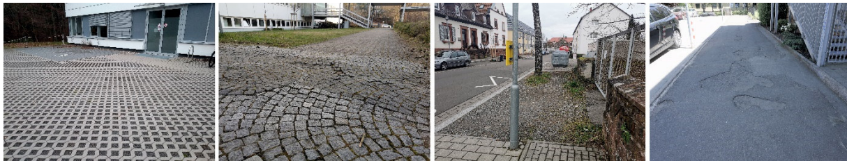
Bodenbelag mit ungeeigneten Materialien oder in schlechtem Zustand
